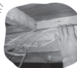
床下のシロアリ被害
